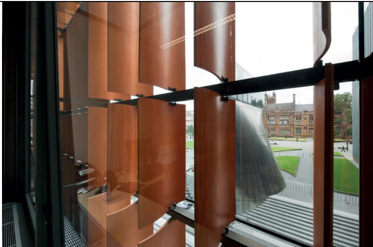
شكل (9أ) يوضح الألواح المكونة للهيكل الخارجي للتحكم في الإضاءة والتظليل https://www.archdaily.com/109736/faculty-of-law-university-of-sydney-fjmt
