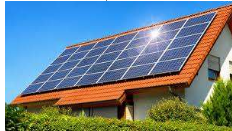
صورة 30 توضح الألواح الشمسية
